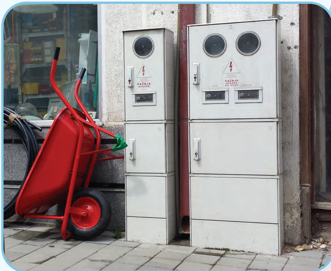
Slobono stojeći uzemni orman za 1 i 2 merna mesta
