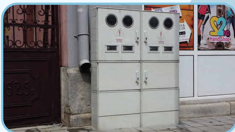
Slobonostojeći uzemni merni orman u Arandjelovcu
