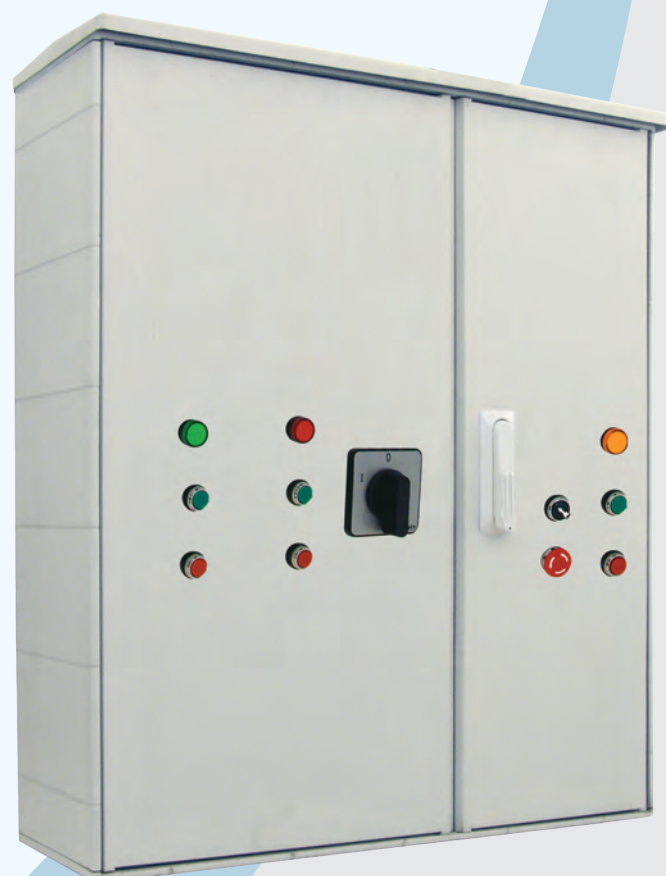
Orman sa prekidačima i kontrolnim lampama
